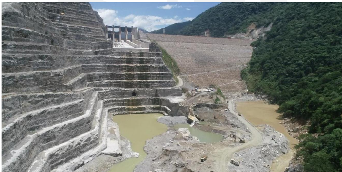
Figura 1.13. Obras de control del flujo del proyecto hidroeléctrico Ituango. Vertedero terminado y presa en su etapa final (Fuente: equipo técnico UNAL, 2018).
