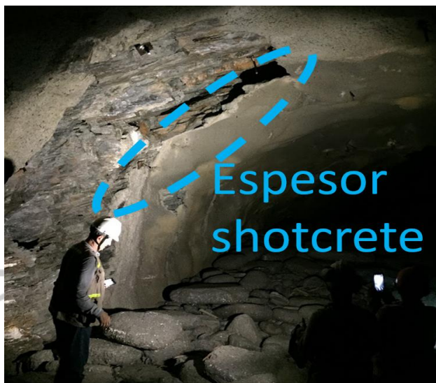
Figura 1.30 Concreto lanzado en túnel de acceso a casa de máquinas (Fuente: Equipo técnico UNAL, 2018).
