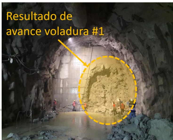
Figura 1.27. Resultados de la voladura # 1 del Tapón No. 9, TDI (Fuente: Equipo técnico UNAL, 2018)
