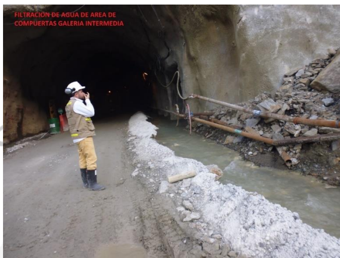
Figura 1.28. Filtración de agua - Descarga Intermedia (Fuente: Equipo técnico UNAL, 2018).
