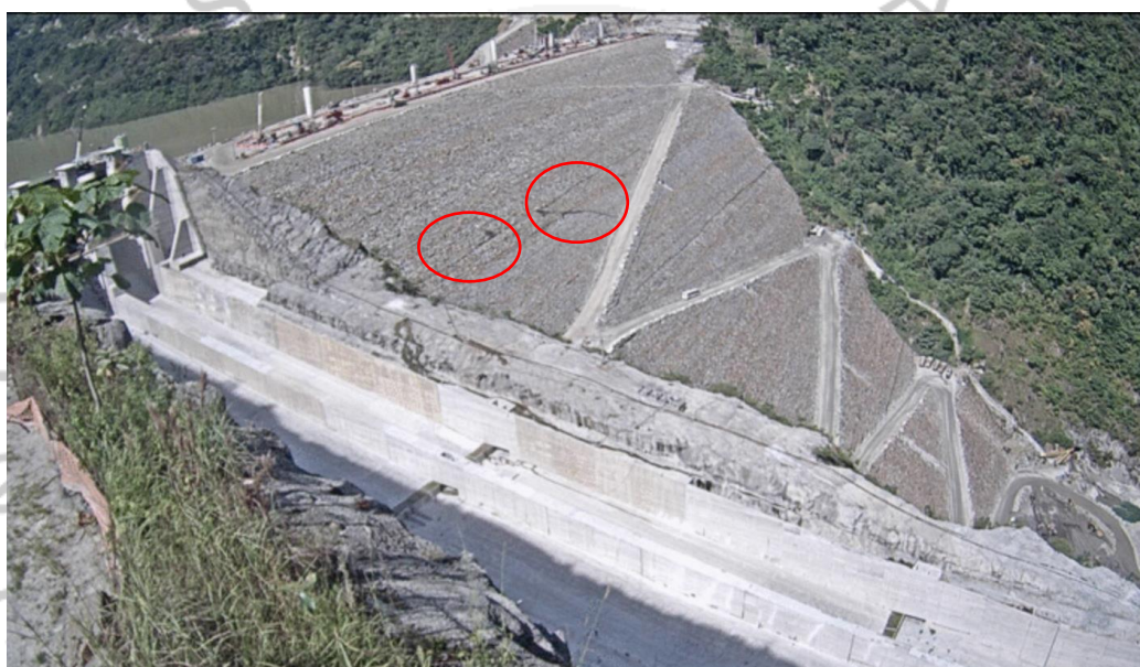
Figura 1.16. Estado actual de la presa donde se observan (círculos) las huellas de las filtraciones (Fuente: Registro SIATA, 24 de octubre de 2018)
