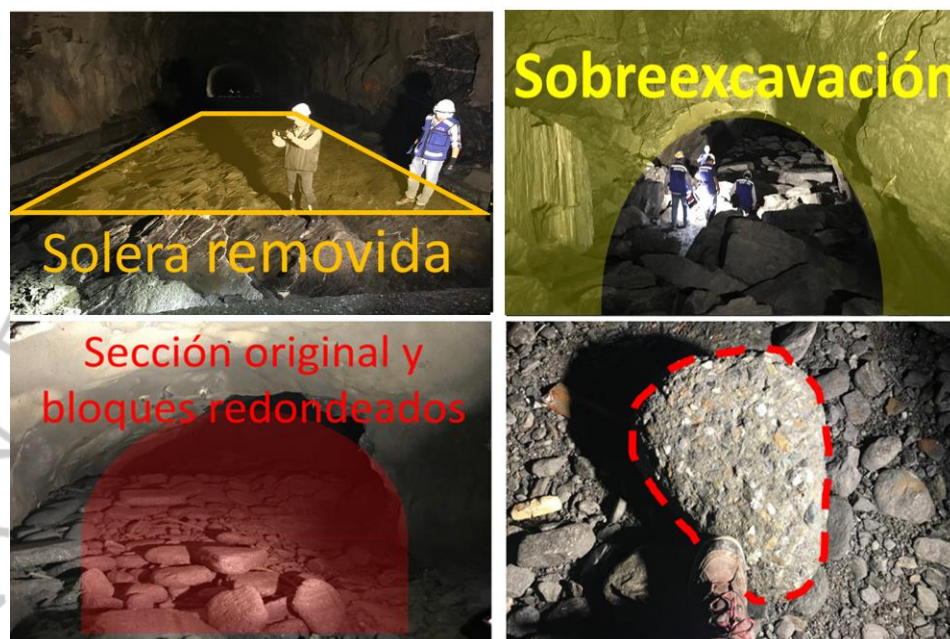
Figura 1.29. Estado del túnel de acceso a casa de máquinas a) Piso y solera b) socavación (Fuente: Equipo UNAL, 2018).
